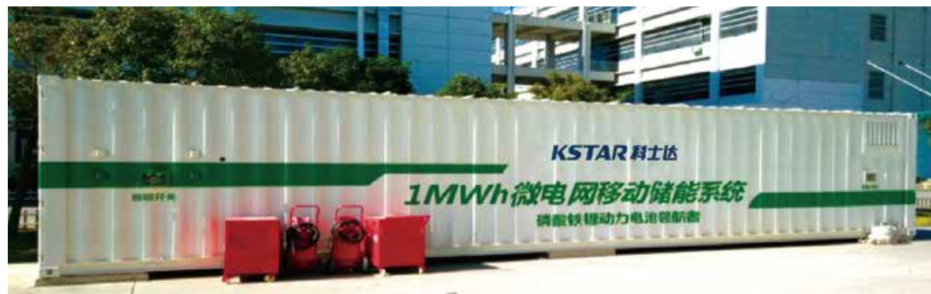
► 3 MW/12 MWh BESS-Demonstrationsprojekt in Shenzhen
