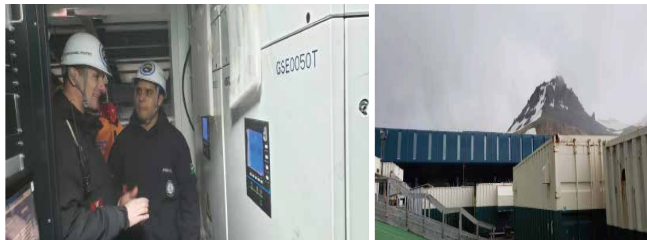
► 300 kWh Speicherprojekt der Antarktis-Forschungsstation des brasilianischen Militärs
