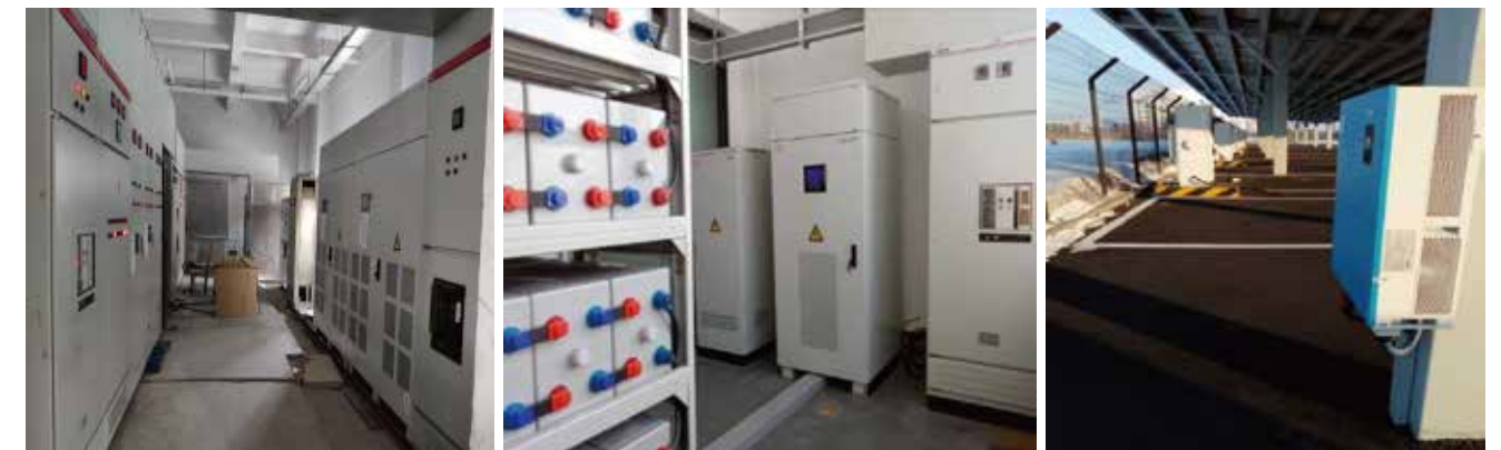
► BESS für EV-Ladestation in Harbin
